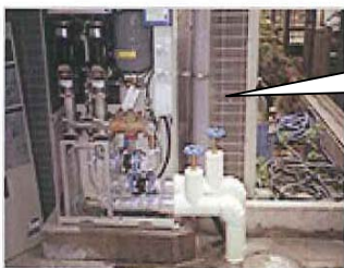
直結増圧ポンプ外観
